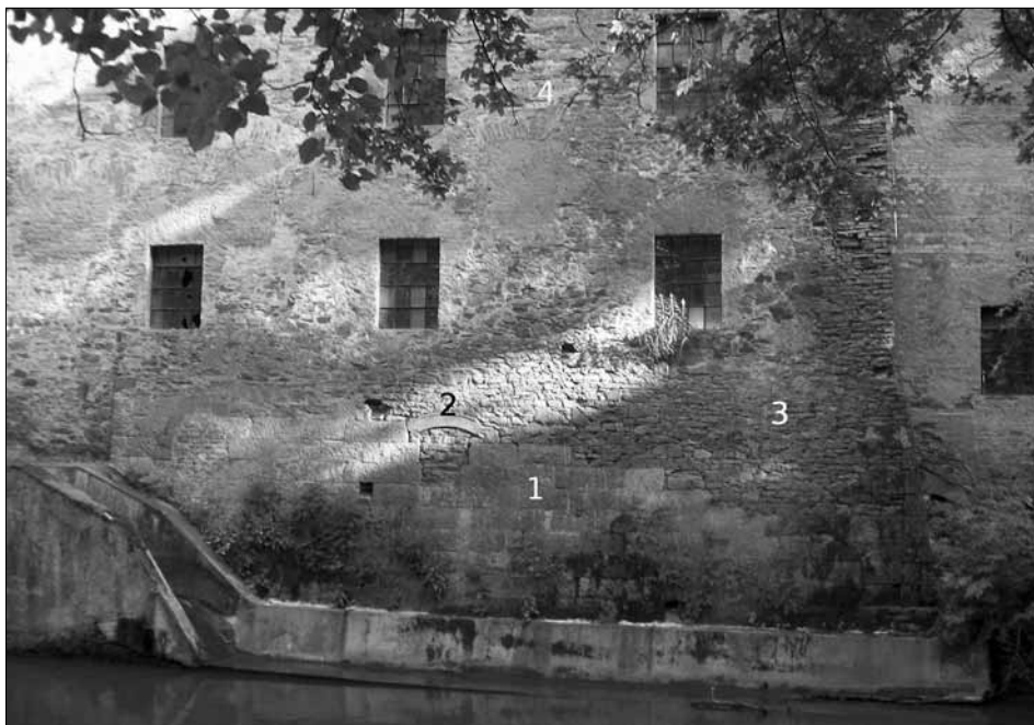
Obr. 1b. Pohled na základy mlýna; 1 – opracované kvádrové pískovcové bloky, 3 – neopracované lomové kamenné zdivo, 4 – pálené cihly, 2 – fragment (autor)
