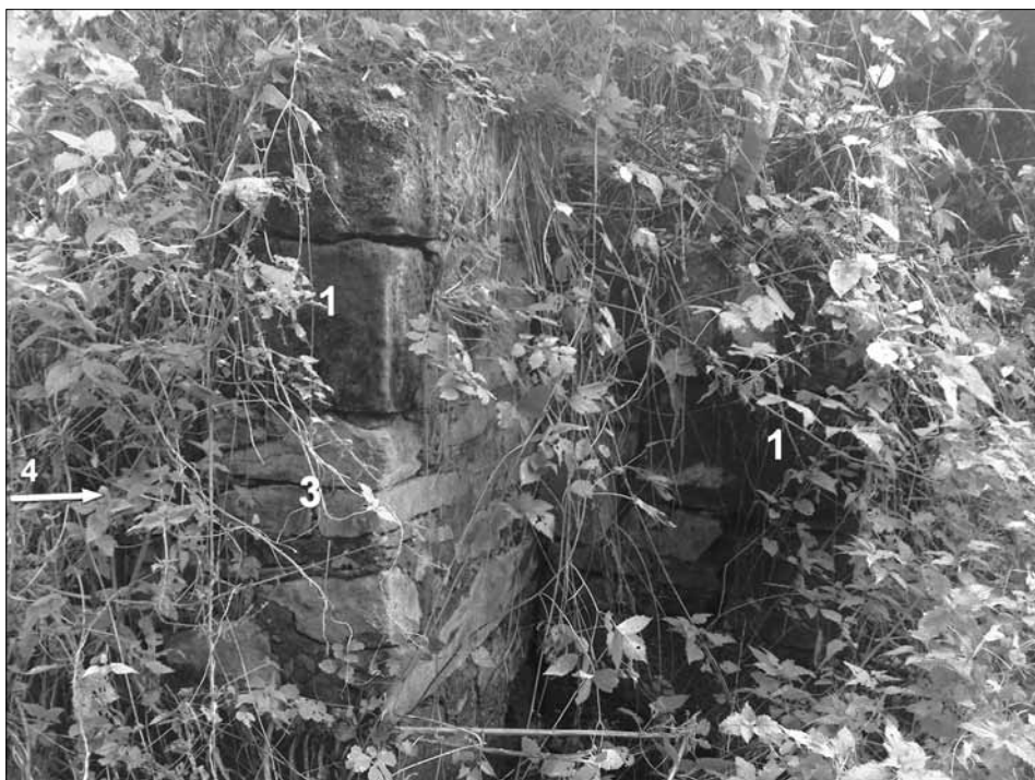
Obr. 11. Detailní záběr základového pilíře jako pozůstatku pilového mlýna – 4; je složen z opracovaných kvádrových pískovcových bloků (1) a neopracovaného lomového kamenného zdiva (3) (autor)
